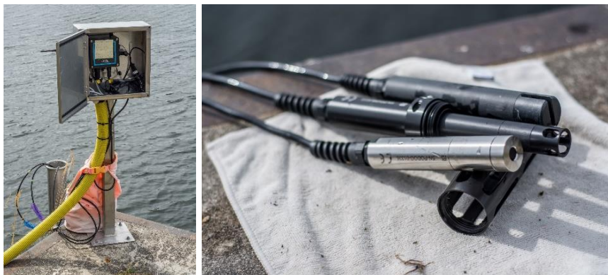
Installation av sensorer vid Lovön (vänster), samt mätsensorer (höger) Foto: Jacopó Cantoni SU.
